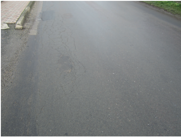
Obrázek 3: Poruchy vozovky dva roky po její opravě
